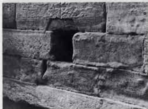
Romanische Basilika Mehrerau. Quadermauerwerk in der Südostecke des Chorabschlusses. Blick nach Südwesten
